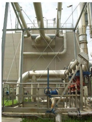
Figura 3 - Impianto di trattamento dei reflui del I Macrolotto
